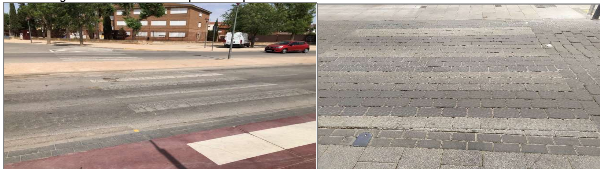
Imagen 39: Problemas en pasos de peatones.
