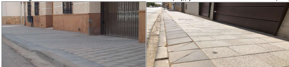
Imagen 34: Vados afectando a toda la sección de acera (izq,) y solo achafanando el bordillo (der.).
