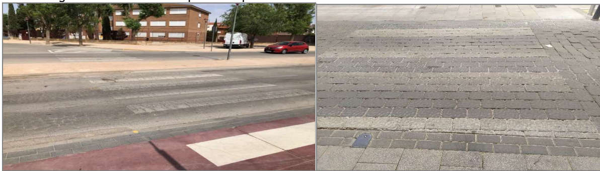
Imagen 39: Problemas en pasos de peatones.
